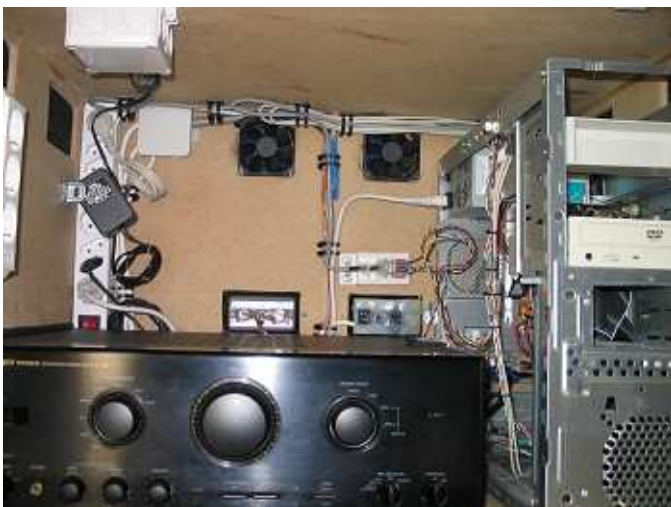
Die fertige Installation. Zwei Steckdosenleisten für Sound und Licht Komponenten. Oben der Fühler für...
